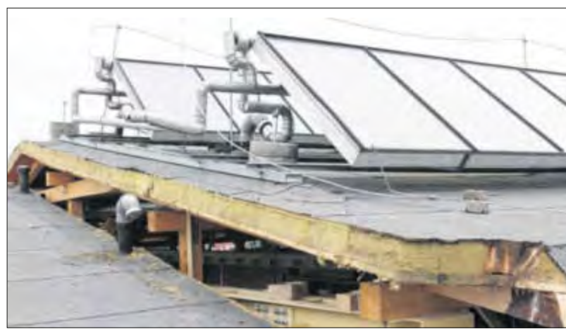
Der erste Schritt ist getan. Bis Freitag soll das Dach auf dem Ostflügel um insgesamt etwa zwei Meter angehoben werden.
