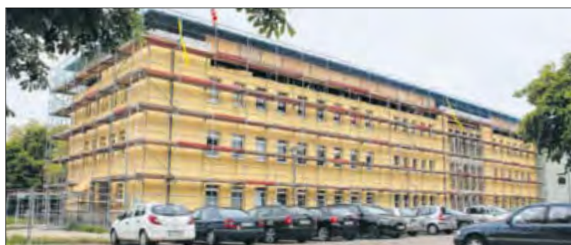
Der letzte Bauabschnitt der Grundsanierung des Wolgaster Krankenhauses dauert voraussichtlich bis zum Herbst 2016. Das Schweriner Sozialministerium fördert die Arbeiten mit 9,7 Millionen Euro.
